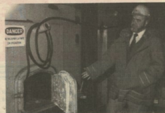
Le député Jim Lafrenière, a tenu à se rendre compte par lui-même de la grandeur imposante de la nouvelle bouilloire installée aux séchoirs à bois.
